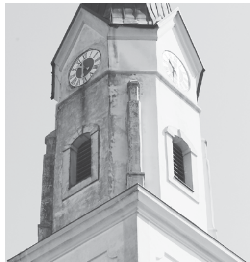
Auf der Westseite weist der Kirchturm durch Verwitterung schwere Schäden auf. Fotos: Schaffarczyk
